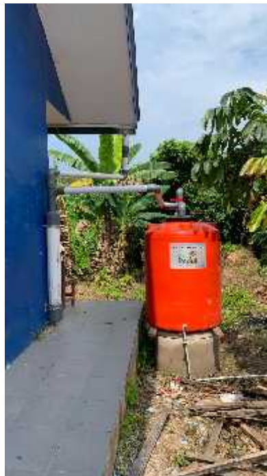
Gambar 3.34 Penampungan air hujan kampung iklim di kecamatan sambutan kota samarinda
